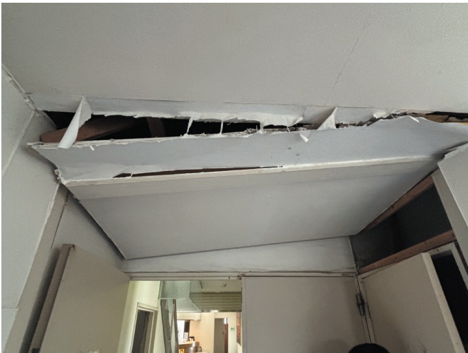
天井が剥がれた医療機関も(八代市)
