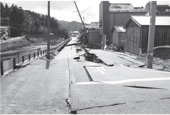
幹線道路から一本入った脇道の復旧はまだ追いついていない
