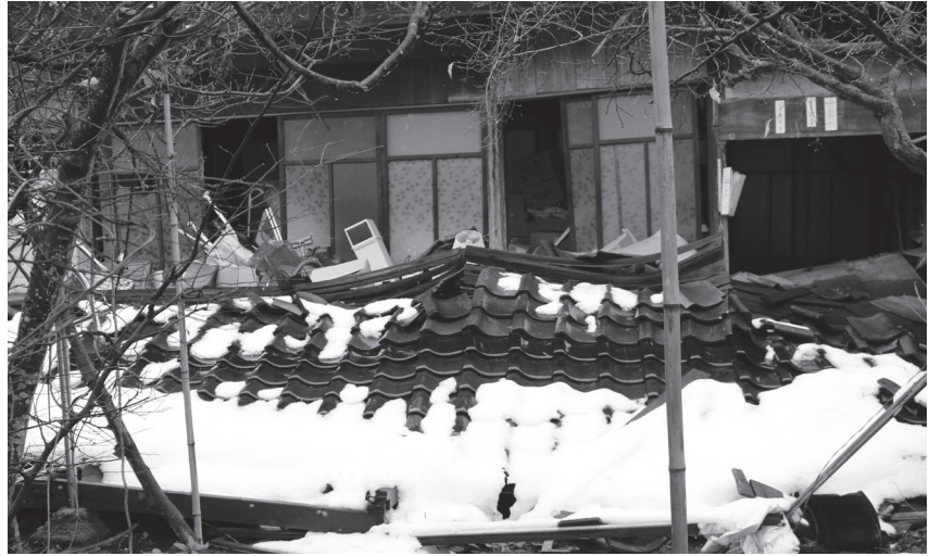
軒が崩れ落ち、家具が散乱している(会員の別宅・穴水町)
